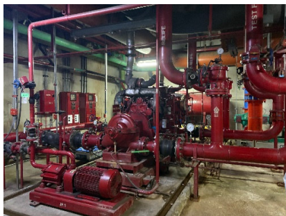
ภาพถ่ายห้องเครื่องสูบน้ำดับเพลิง (Fire Pump Room)
